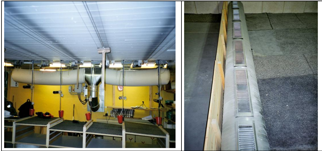
Eksempel på to symmetrisk placerede indblæsningsposer, er vist på billedet til venstre. Eksempel på komplet udsugningskanal placeret på gulv, er vist på billedet til højre.
